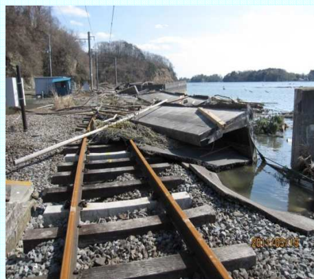
写真② 仙石線陸前富山駅付近:津波により破壊された堤防が、レールの上に乗上げていた。駅のプラットフォームも一部破壊されていた。向って右に見える海は松島湾。
